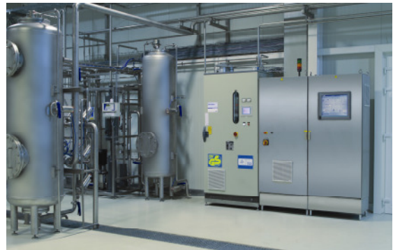
Bild 2: Ozonanlage in der Mineralwasseraufbereitung
