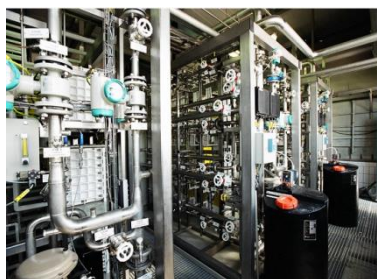
Abbildung 5: EDI Anlage Leistung 5 x 60 m 3 /h mit je 15 Modulen pro Rack (Bild: Hager+Elsässer GmbH)
